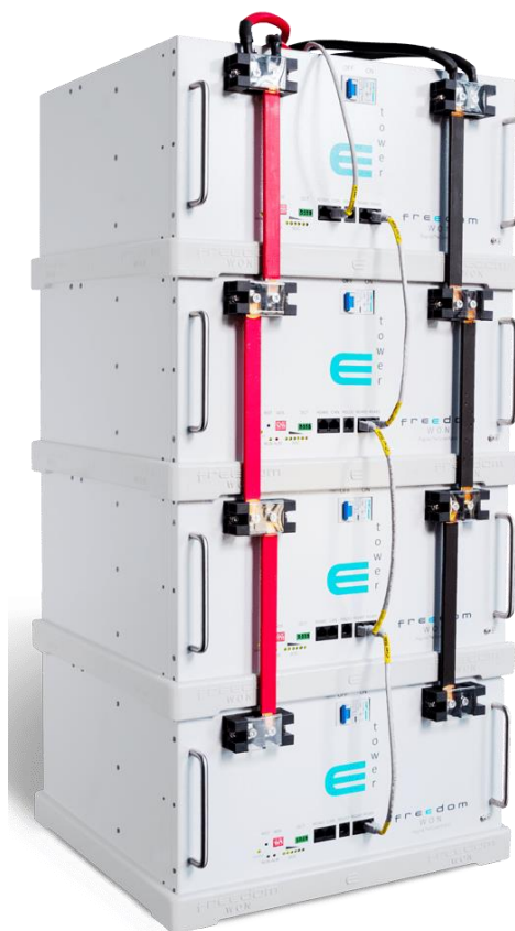
Figura 51. Bateria de ião de lítio
